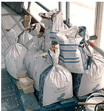
Le mortier de ragréage prêt à l'emploi, a été spécifiquement formulé pour ce chantier.
