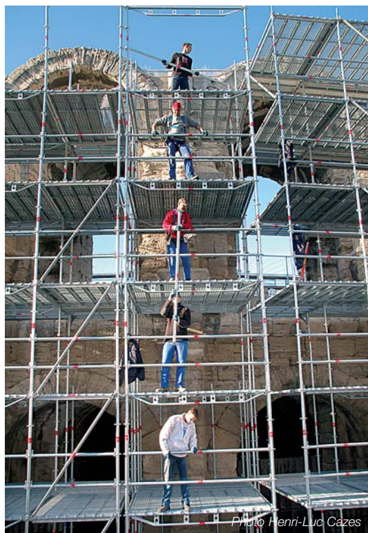
L'échafaudage est aussi un élément important dans la conduite du chantier de restauration.
