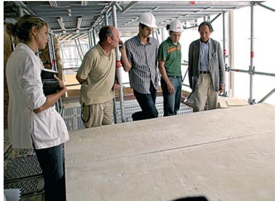
Alain-Charles Perrot vérifie la qualité du moulage des dalles du promenoir réalisées en béton fibré.
